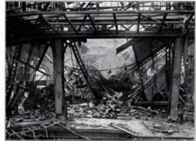
Fig. 58. — Intérieur du bâtiment principal de Valenciennes après destruction.
